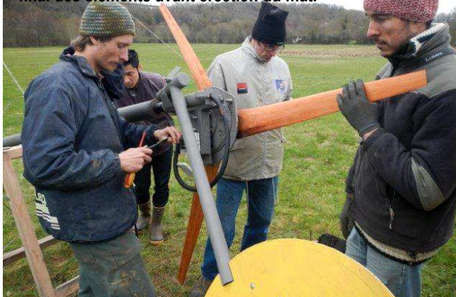
Atelier de construction d'éolienne : assemblage final des éléments avant érection du mat.
